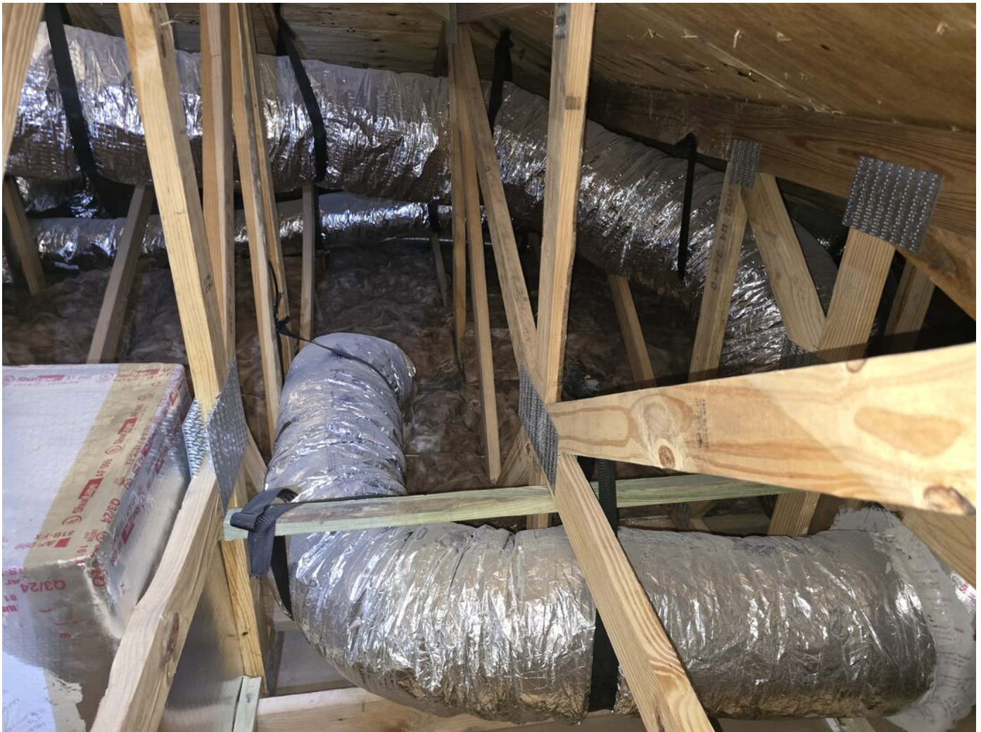
Ductos y aislamiento / Ducts and insulation
