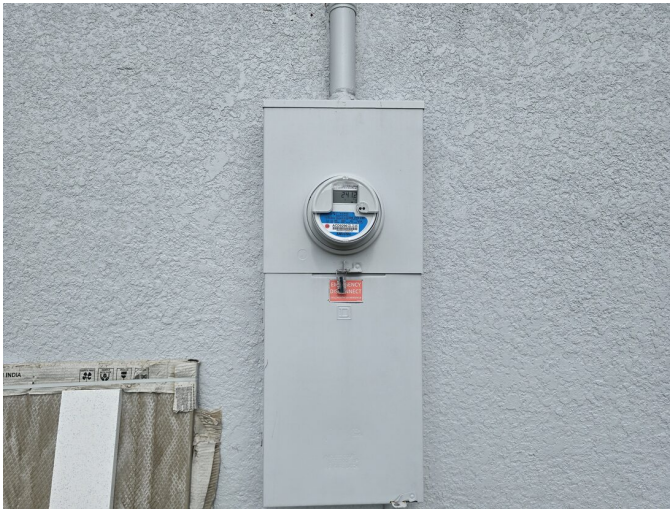
Medidor eléctrico / Electric meter
