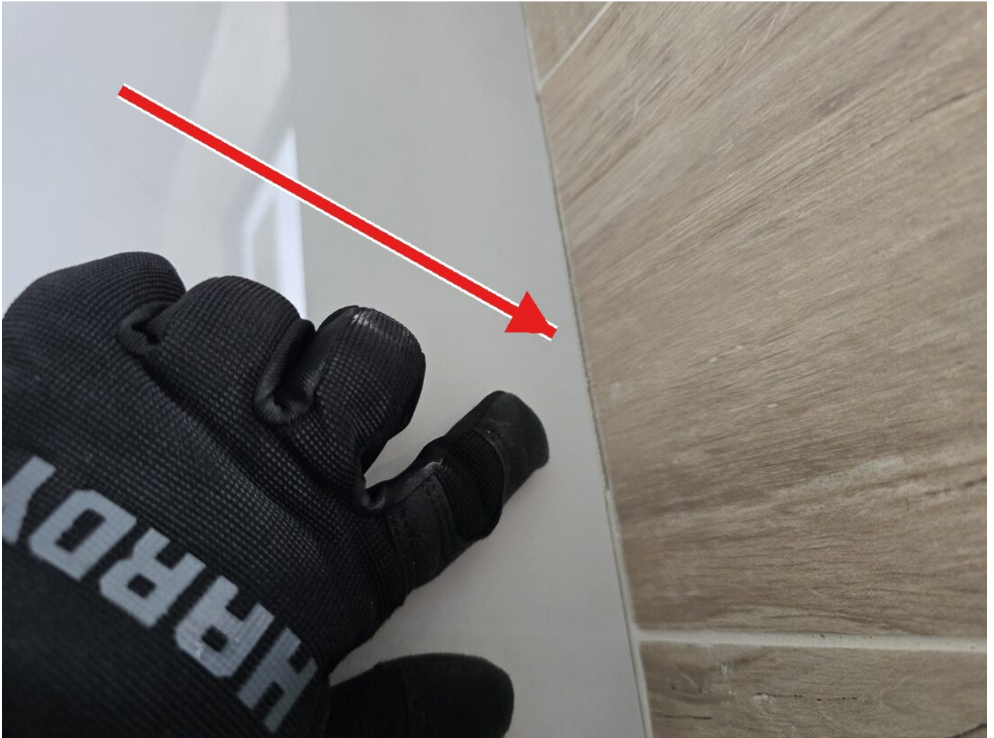
Espacio sin sellar en transición / Unsealed gap at transition
