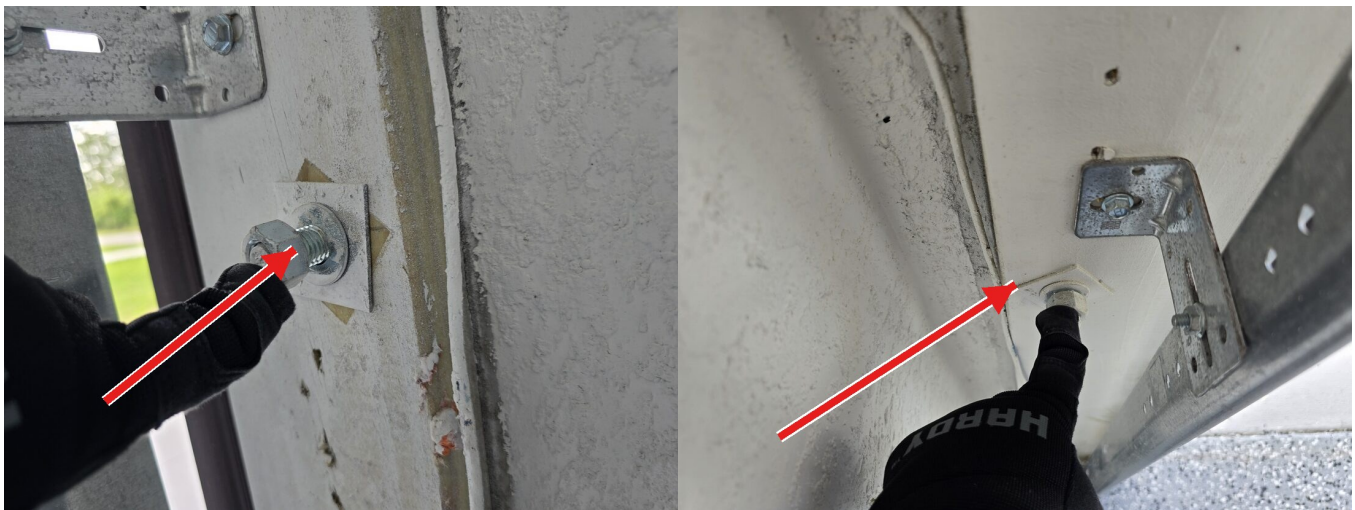
Anclaje flojo del riel / Loose track anchor
