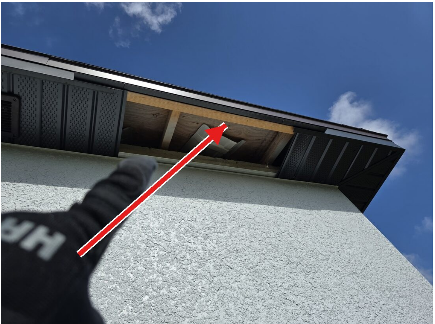
Soffit abierto con aislamiento expuesto / Open soffit with exposed insulation
