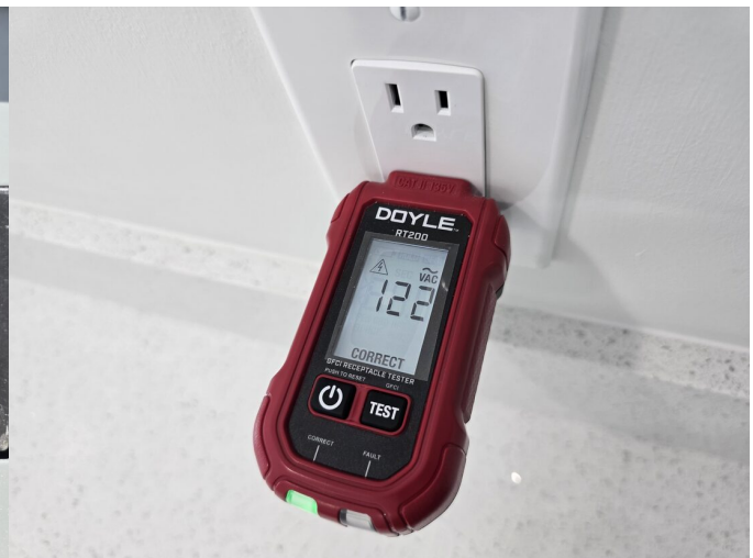
Prueba de tomacorriente correcta / Correct receptacle test
