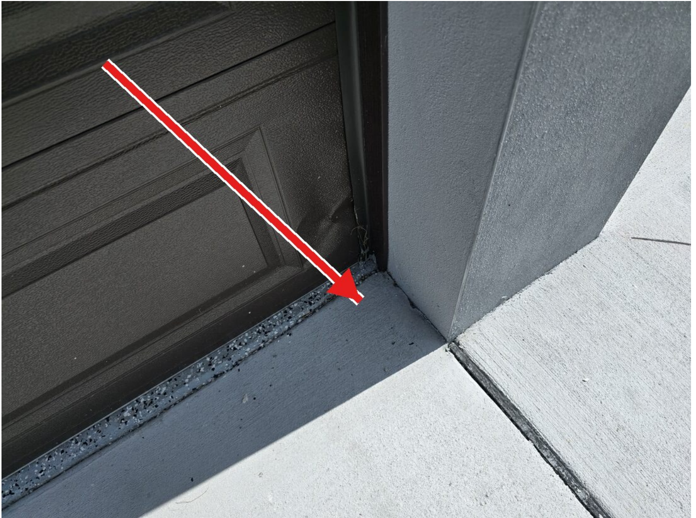
Golpes menores en panel de puerta / Minor dents on door panel
