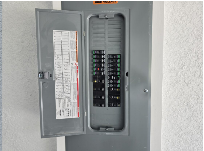
Panel de distribución / Distribution panel
