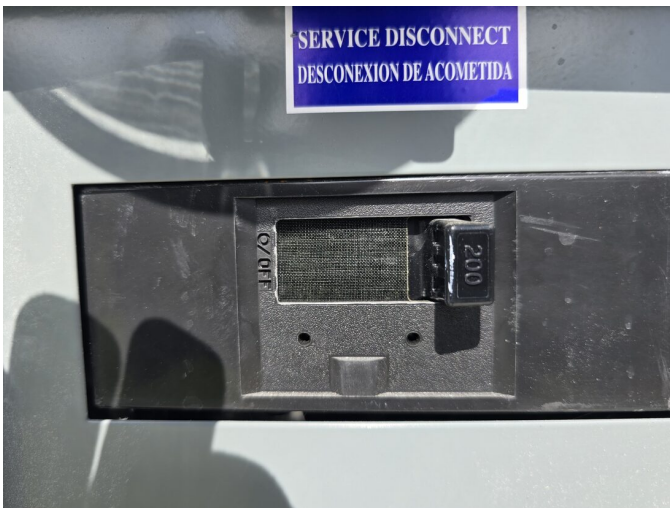
Desconexión de servicio 200A / 200A service disconnect
