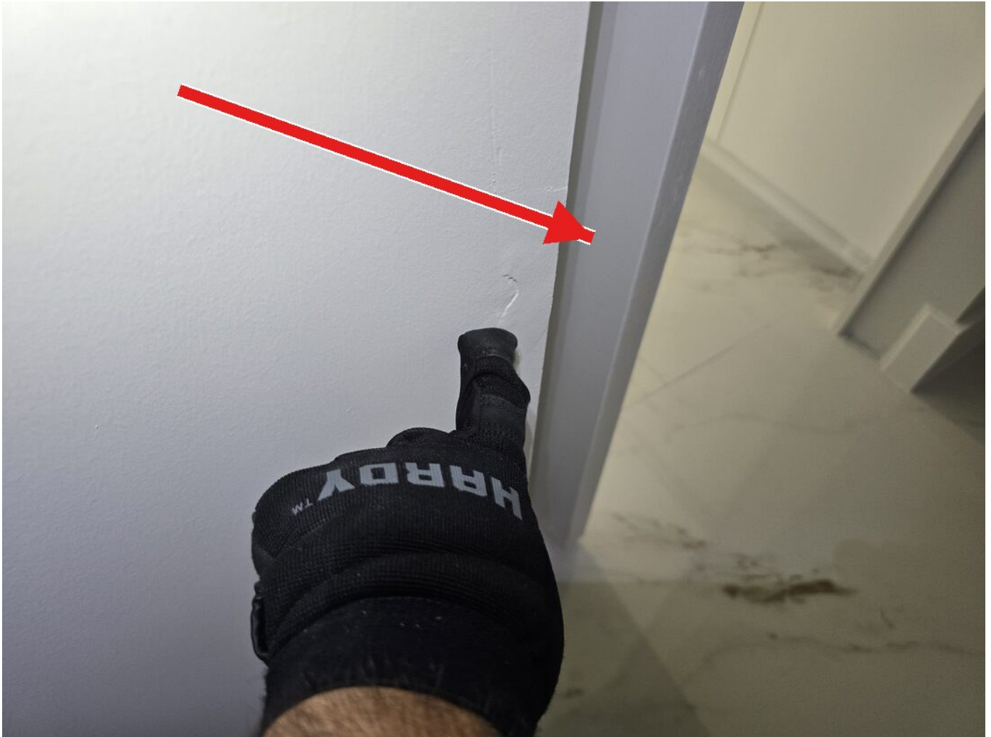
Grieta capilar junto a marco / Hairline crack at frame
