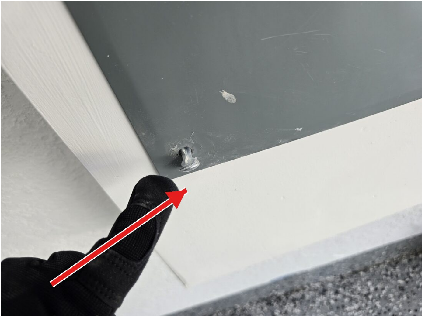
Tornillo suelto en gabinete del panel / Loose screw at panel enclosure
